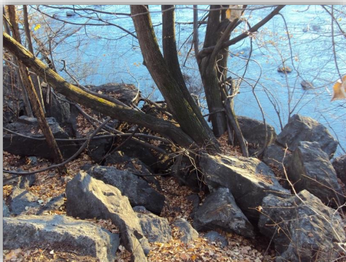
Foto 5. Locarno, argine sommergibile. Grandi alberi destabilizzano l'alveo e vanno pertanto tagliati.
