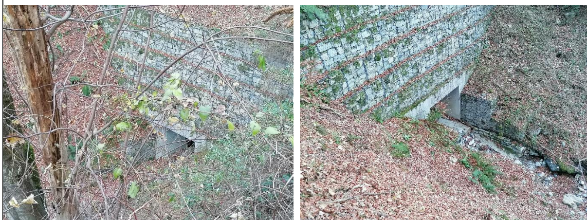
Figura: interrimento del riale a Casima in località In Germagna. Il tratto intubato e tutta l'asta a monte sono stati esclusi dalla certificazione a causa dell'intubamento del corso d'acqua (coord.: 2'723'930, 1'083'309).
